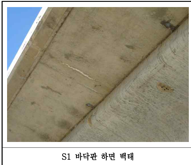
【사진 36.3.23】바닥판하면 손상현황
