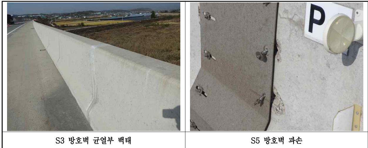
【사진 36.3.21】 방호벽 및 중앙분리대 손상현황
