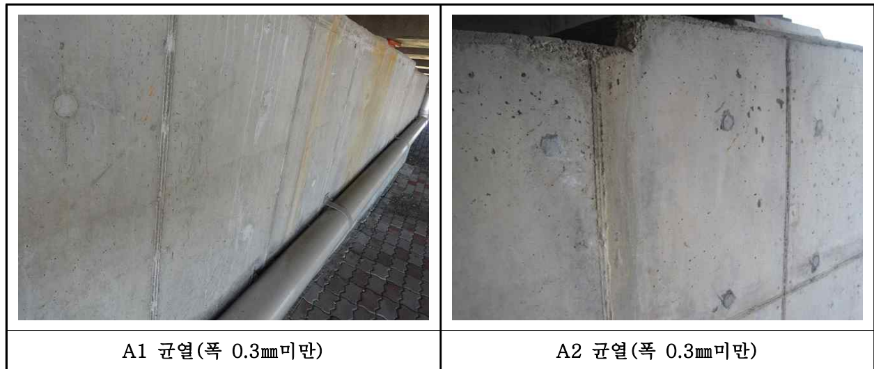
【사진 36.3.27】 교대 손상현황
