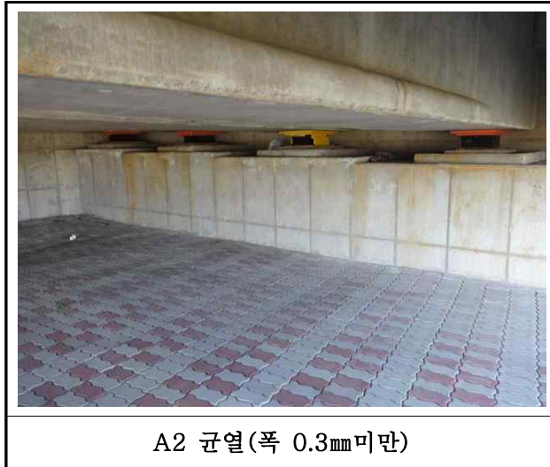
【사진 36.3.7】 교대 손상현황
