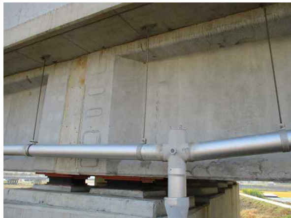
S2-G1 거더 균열(폭0.3mm미만)
