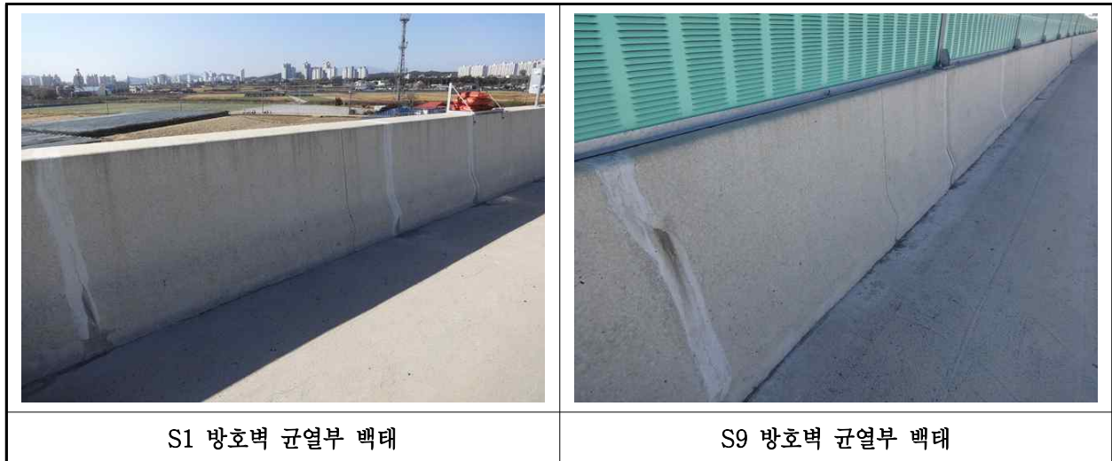
【사진 36.3.41】 방호벽 및 중앙분리대 손상현황
